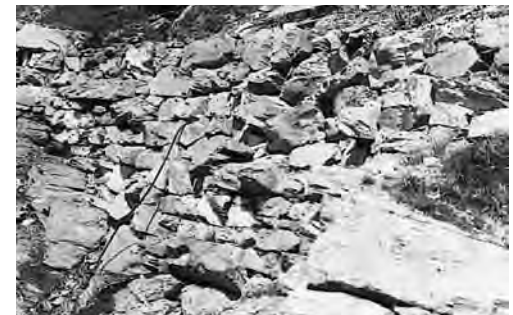
Alte Sperrmauer mit typischen Zerfallserscheinungen.
