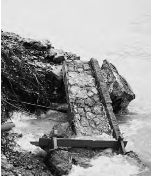
Zerstörter Quai vor dem Änderdorf.
