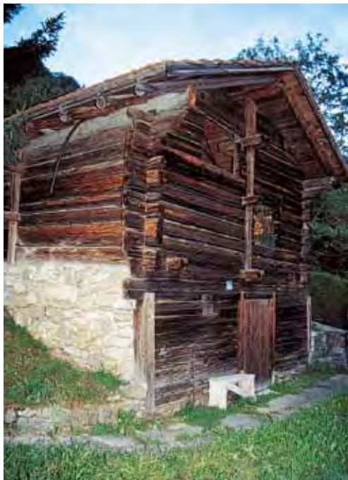
An der Scheuer der Birgigasse ist dank der später ausgesägten Öffnung die oberste Klammer vollständig sichtbar.
