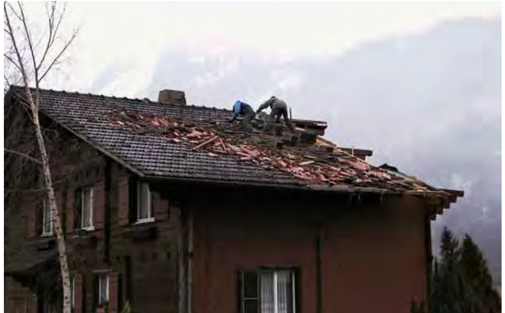
«Lothars» Zerstörungswerk an Dächern...
