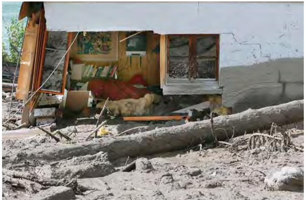
Vershobenes und zerstörtes Haus am Glyssibach.
