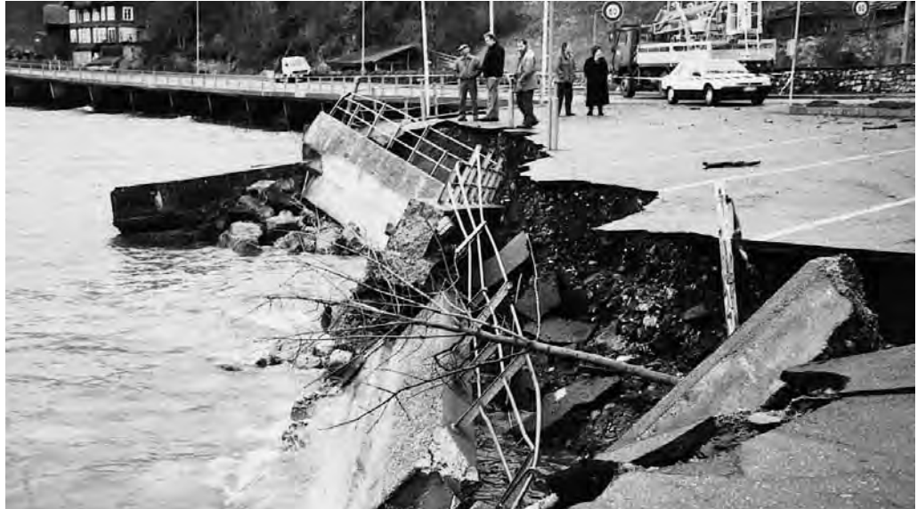
Unterspülter Parkplatz Lindellen.
