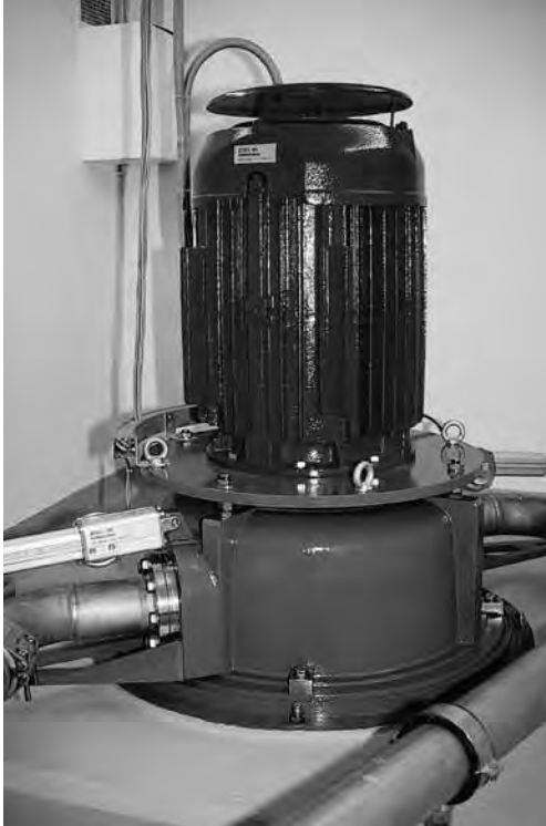
Elektrizität aus Trinkwasser: Turbine und Generator im Reservoir Breitenberg.
